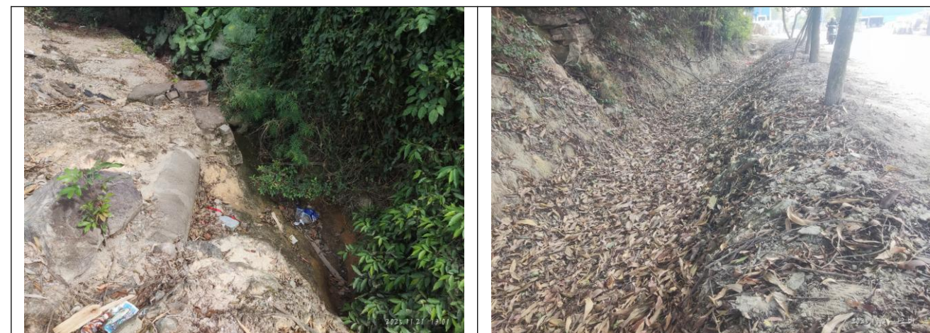
图 3.1 土质边沟堵塞、排水不畅
